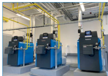
■ Modernizovaná kotelna U Jičínky.
