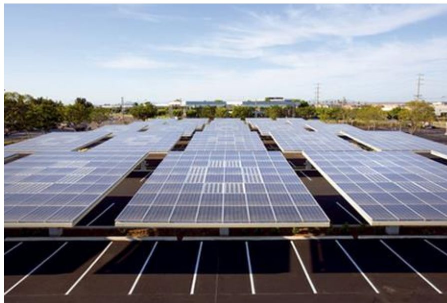
Stínění pomocí FVE panelů. ( https://www.asb-portal.cz/stavebnictvi/technicka-zarizeni-budov/fotovoltaika/solarni-parkoviste-vice-uzitku-zjedne-instalace )
