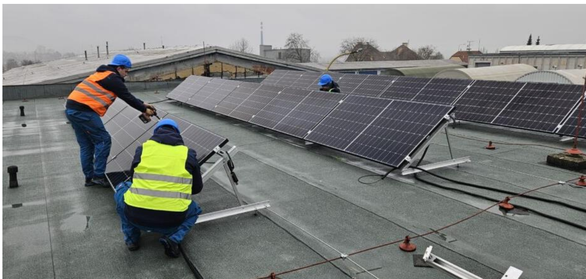
První fotovoltaická elektrárna na střechách budovy Technických služeb Nového Jičína
